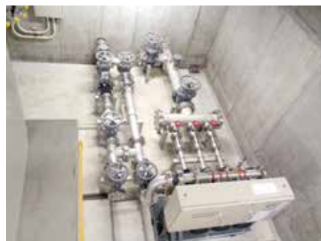
▲向山加圧ポンプ設備
