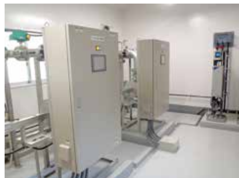
▲大呂川上浄水場の紫外線照射設備
