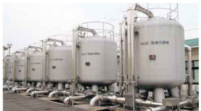
▲灘分浄水場、ろ過機
