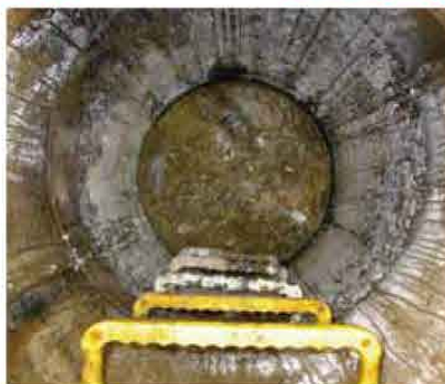
▲油が冷えて固まりマンホール内に詰まってしまい、汚水が流れなくなりました。
