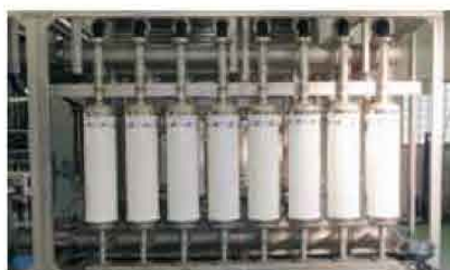
▲多伎簡水膜ろ過施設
