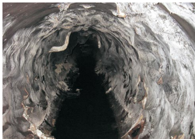
▲腐食し老朽化した下水道管(管路更生工事 着工前)
