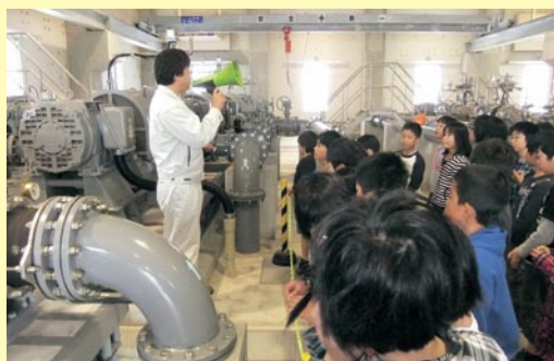
▲見学の様子(来原浄水場 送水ポンプ室)
