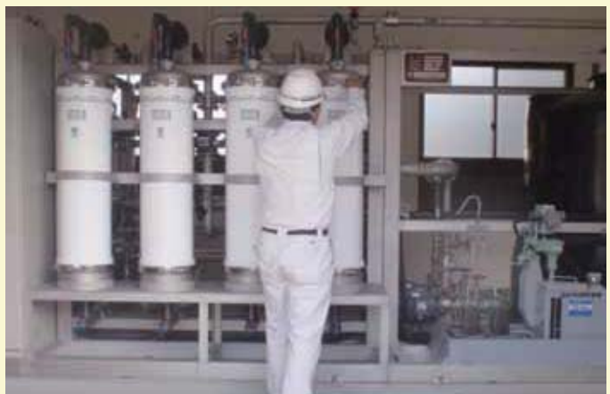
須佐簡易水道朝原浄水場に整備している膜処理設備▶
