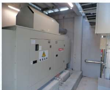
自家発電施設
