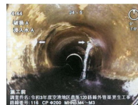
下水道管のひび割れからの浸入水
