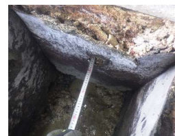
水路壁の剥がれ落ち
