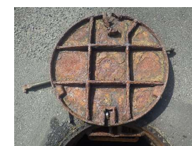
マンホール蓋の腐れ
