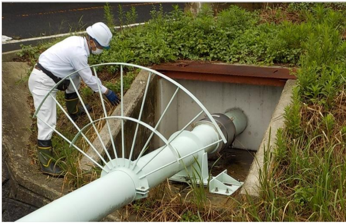
被害状況確認
