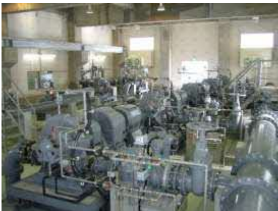
来原浄水場送水ポンプ室
