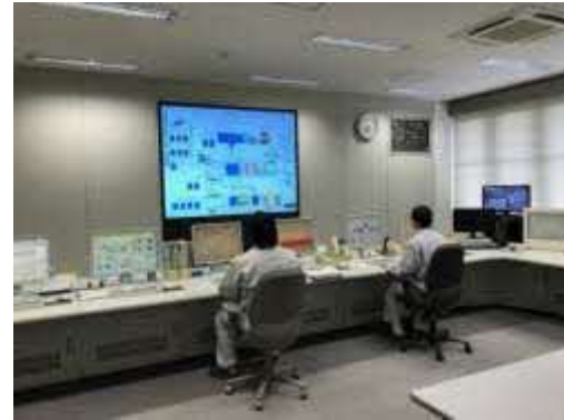
来原浄水場中央監視室
