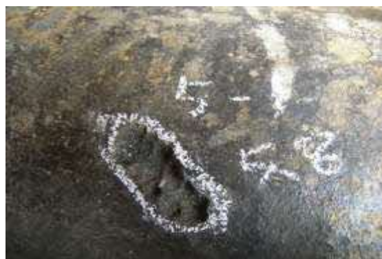
管体調査で明らかになった腐食の進んだ水道管(铸铁管)
